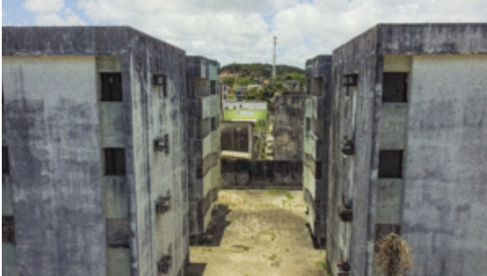
Prédios-caixão abandonados em Recife (PE) pelo risco de desabamento estão entre imóveis alvo de acordo para indenização securitária
