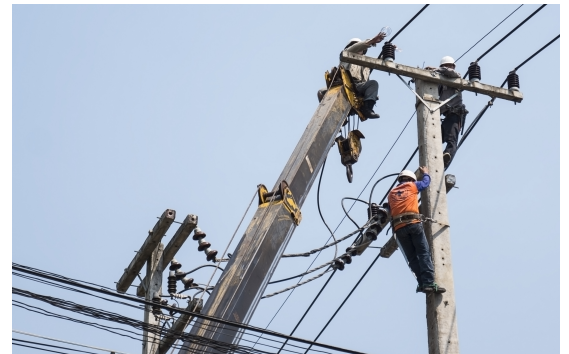
Trabalhador encostou em fios elétricos em acidente e sofreu queimaduras graves
