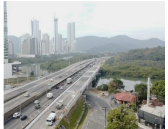
Obras na BR-101 ocorreram em área pública já desapropriada, concluiu o TRF-4
