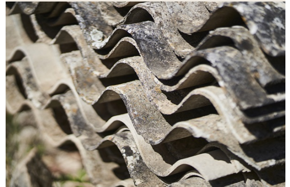
Amianto é usado para produzir telhas e outros materiais usados na construção civil
